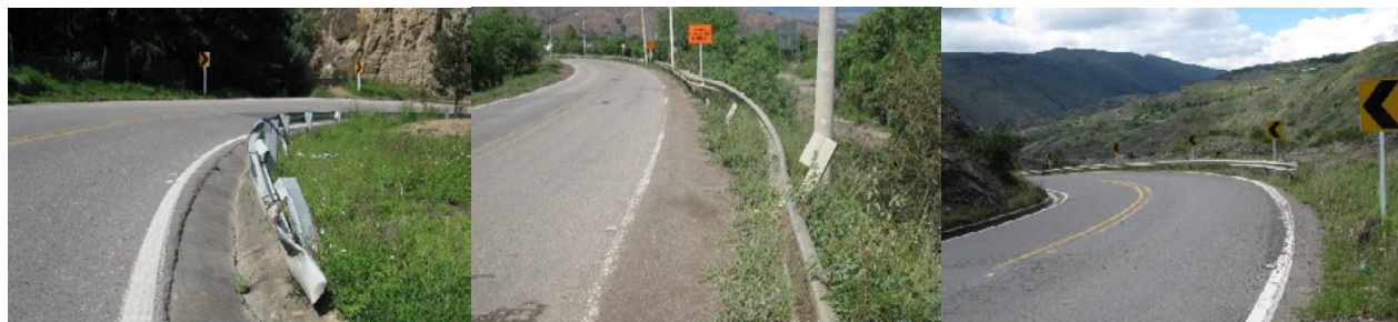
Figura 3. Barreras pegadas a la calzada, sin mantenimiento y longitud insuficiente
