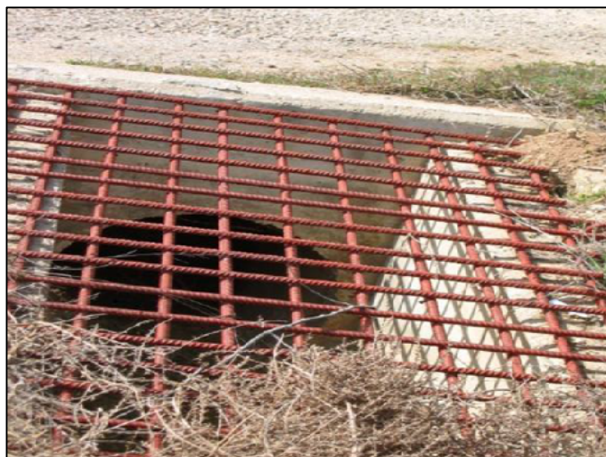
Figura 6. Modificación de la salida de obras de arte, diseño traspasable Fuente. Asociación Española de Carreteras.
