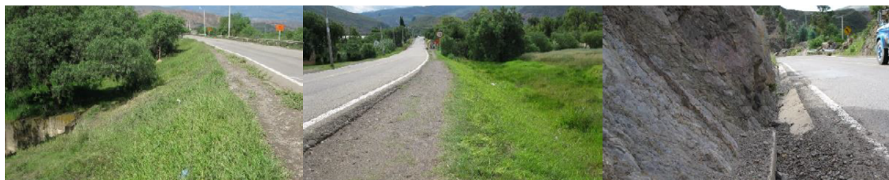
Figura 1. Ausencia de bermas, taludes muy inclinados y pegados a la calzada
